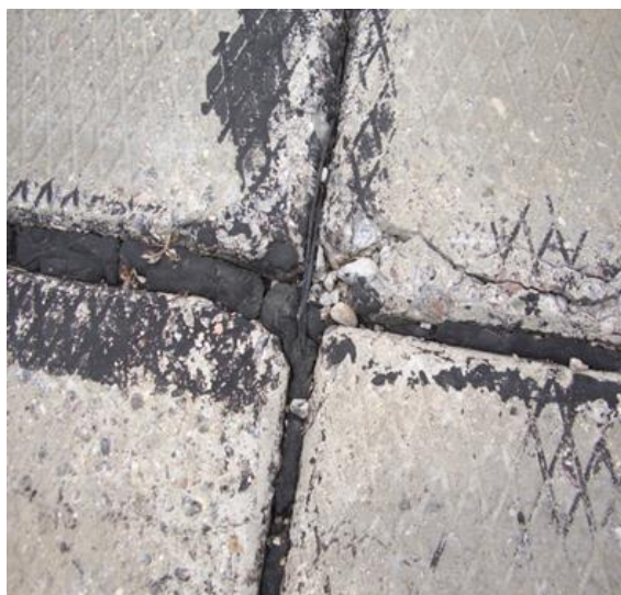
Рис. 1. Разрушение бетонного покрытия ВПП и РД
